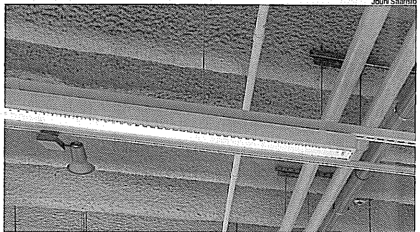
Monokote MK-6 HY -tuotetta on käytetty Turun Wiklund-projektissa lieäämään TT-laattojen palonkestoa. Hanke on esitelty tässä lehdessä.
